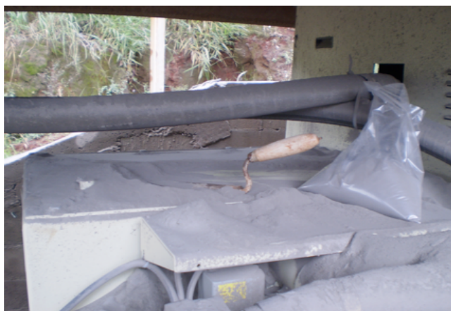
Figura 1. Acúmulo de pó de diabásio sobre equipamento em equipamento no pátio de operações em uma empresa de britagem.
